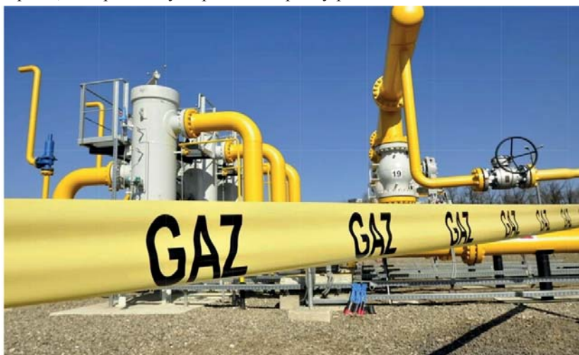
Рис. 5. Трубопровод для транспортировки природного газа.
